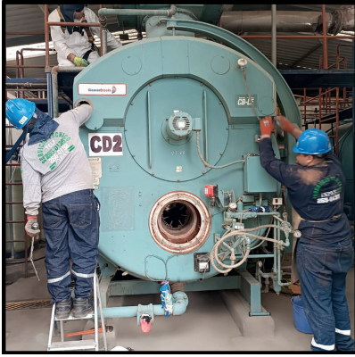
MANTENIMIENTO DE CALDERAS
